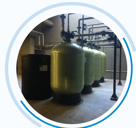
Torre de Refrigeración y equipo asociado de pretratamiento del agua en el Aeropuerto Internacional de Phoenix Sky Harbor.
