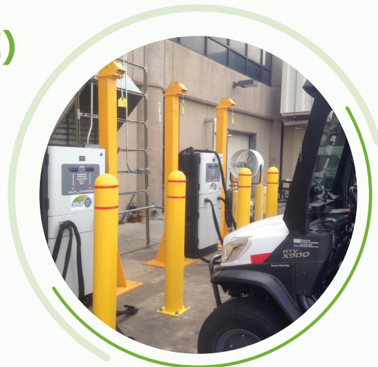
Maquinaria Terrestre Eléctrica y Estaciones de Carga
